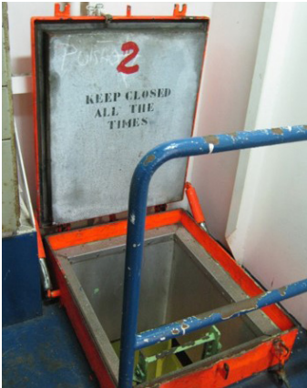
Opgelet voor open mangaten.
